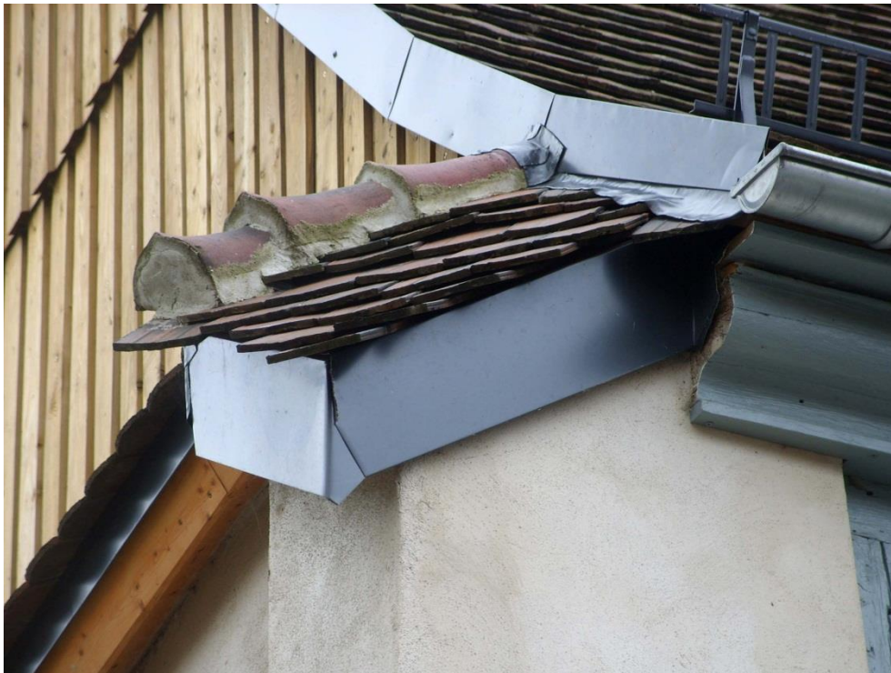
Bild 11: Das Foto zeigt die Verbretterung des Spitzgiebels sowie die Konstruktion der Mauerabdeckung mit dem komplizierten Übergang zum Dach.
