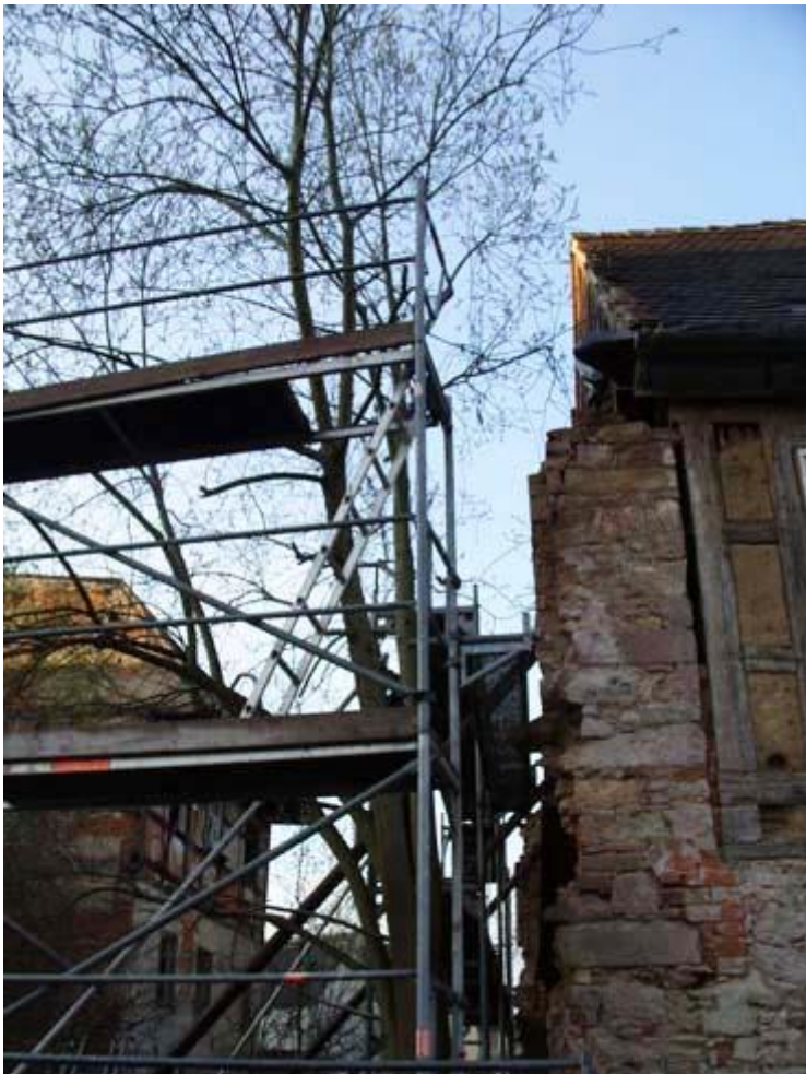
Bild 8: Das merkwürdige Gerüst galt nicht dem Baum, sondern war den ungünstigen Gegebenheiten der provisorischen Giebelsicherung geschuldet. Im Foto sind auch die durchgehende Fuge zwischen Giebelmauer und Straßenfassade sowie der Ausgangszustand des Fachwerkes zu erkennen.
