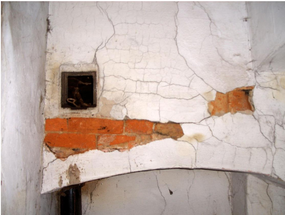
Bild 9: Der Schornstein „schwebte“ auf einem Ziegelbogen, der unter dieser Last drauf und dran war, den Geist aufzugeben.
