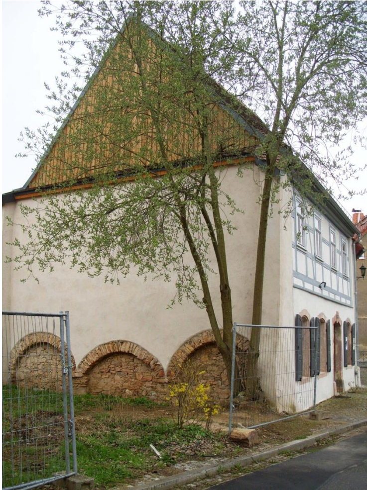
Bild 23: Das zeitgeschichtlich völlig uneinheitliche Ensemble der original zweigeschossigen Giebelmauer - außer den Bogen-Ausmauerungen, deren Schichten auch aus unterschiedlichen Bauzeiten stammen bzw. stammten - und der erneuerten Mauerstümpfe aus dem Bestand des ehemaligen Nachbarhauses wurden schlicht und einheitlich verputzt und angestrichen. Die Natursteinbögen mit den kapitellartig geschmückten Stützen sollen dagegen gut sichtbar an die Zeit erinnern, da sie offen standen und als urtümliche Eingangssituation der Untermühle für Antriebswasser und Mahlgäste dienten. Auch der Weidenbaum genießt Bestandsschutz.
