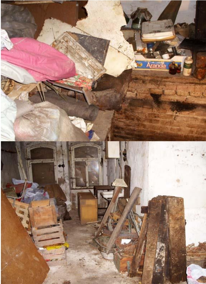
Bild 4: Das Gebäude drohte überall im Müll zu ersticken.
