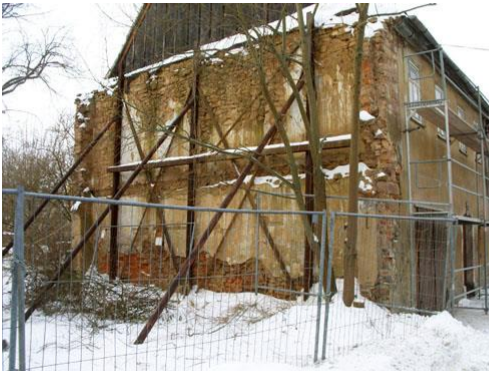
Bild 6: Der Giebel war provisorisch mit einer Stahlkonstruktion und mit Dachpappe gesichert.
